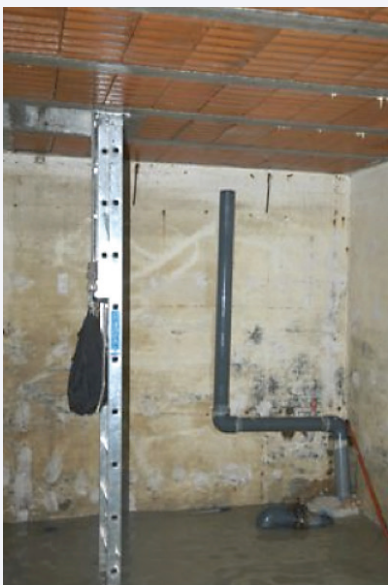
Interior del vaso de expansión y escalera manual de acceso
